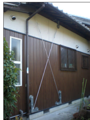
標準タイプ設置状況
