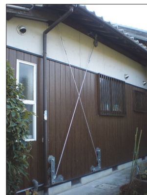
標準タイプ設置状況
