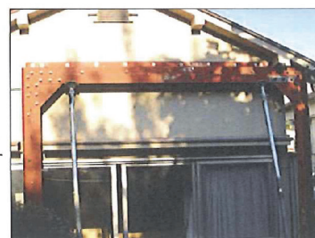
4. ガンコモンG2上部 鉄骨フレーム取付 モルタル外壁の上 からコーチボルト で梁に緊結。 LアングルをH.T.B. で組立、鉄骨フレ ームを造る。
